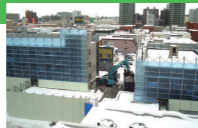
全面新築工事開始 まだまだ雪の多い2月に解体工事が始まる。
